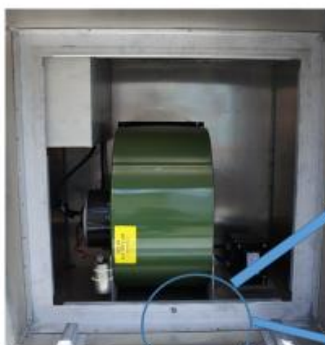
集じん・排気装置 吸気側からみた内部 例
