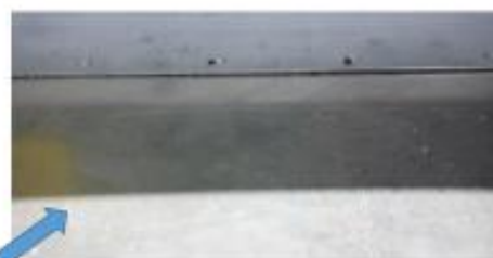
HEPA設置側の隙間 コーキングなし
